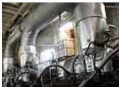
Hoofdmotor met uitlaatgasturbine en afvoer
